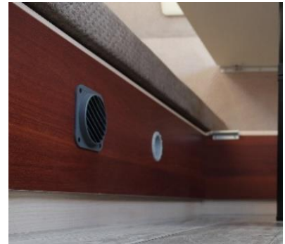
Foto 8. Lüftung in den Bettkästen
