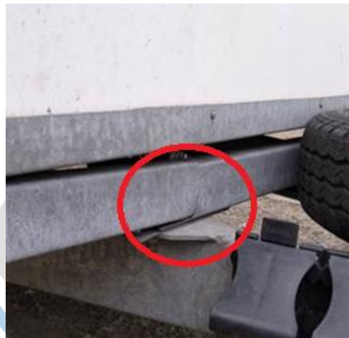
Photo 2. Poutre cassée à cause d'une surcharge - ce défaut ne peut pas faire l'objet d'une réclamation
