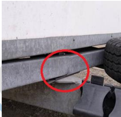
Fot. 2. Złamana belka, która uszkodzona została na skutek przeciążenia- wada nie podlega reklamacji
